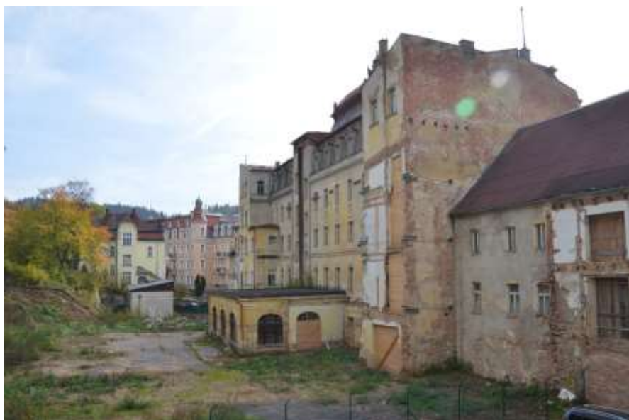
Obr. 3. – havarijní stav domů č.p. 10/13, 9/15 a 8/17
